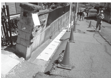
仙台市内での造成地被害視察(H23.5.15)
