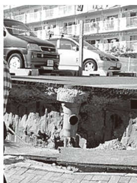
マンションにおける液状化被害調査 (H23.3.12)
